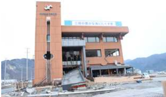
崩れたままの商工会議所。
