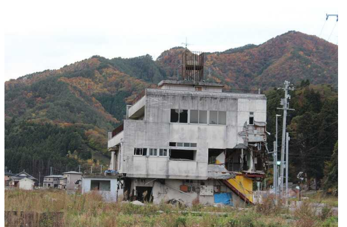
取り残された壊れた建物
