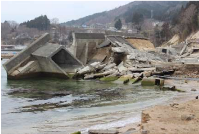
崩壊した防波堤
