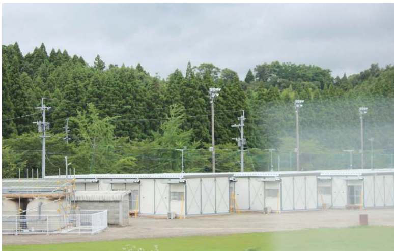
仮設住宅の建設が進み一部が完成。これから入居が始まる。
