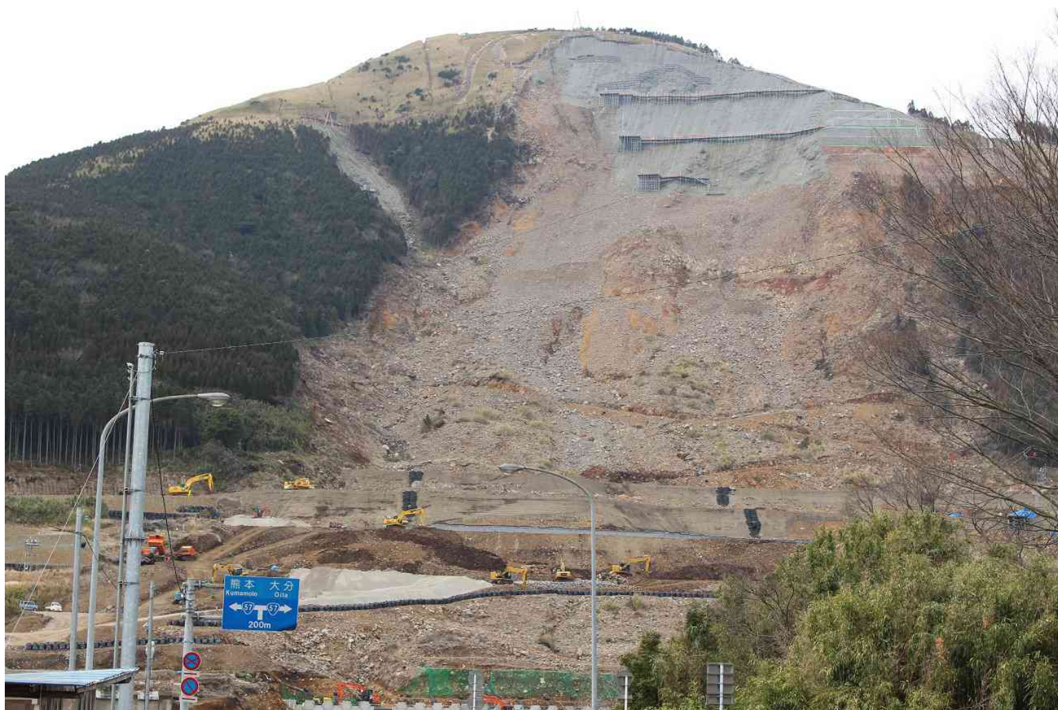
被災の激しかった阿蘇大橋付近。現在も通行止めで復旧工事が続く
